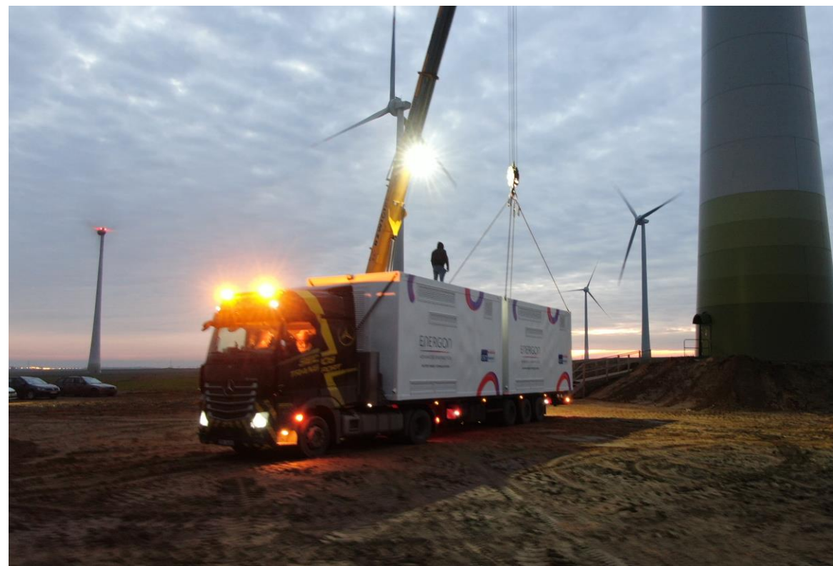
Dostawa czterech magazynów o pojemności 3MW/h i mocy 1,5MW
